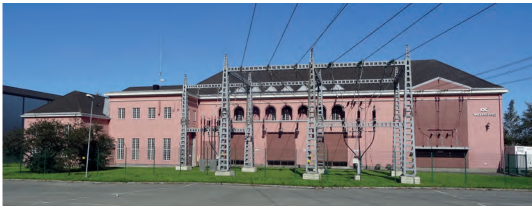
Sørsiden av Moholt transformatorstasjon i september 2018. Fra venstre: Fløy for 6,6 kV anlegget, fløy for verksted og kontrollrom og hovedfløy for transformatorene. Foto: Knut L. Vik.
